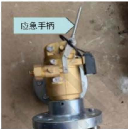
图 3.4.9 消防主管路上施放阀
