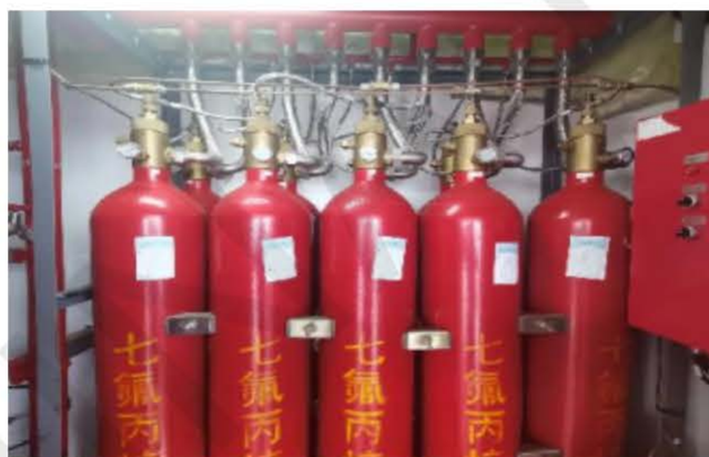
图 3.4.1 七氟丙烷固定灭火系统
