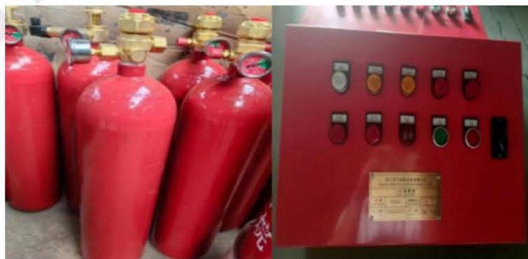
图 3.4.2 灭火剂储存装置 图 3.4.3 主控报警箱
